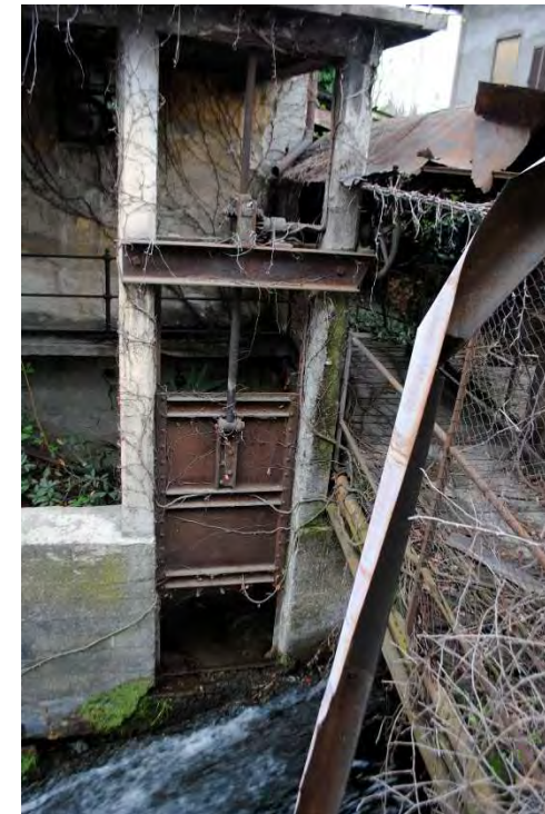
Dettaglio della paratoia sul Rio Moirano
