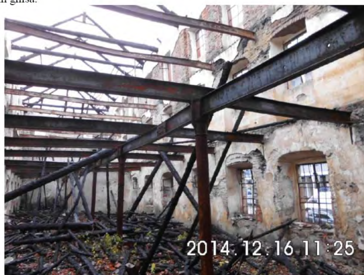
Foto particolari del solaio su piano primo e su piano secondo, si notano le colonne in ghisa e le travi principali in ghisa.
