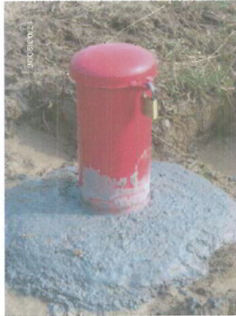
Particolare fotografico del terminale di protezione di S3
