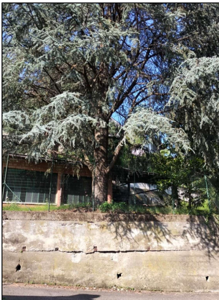
Foto n. 1 – cedro dell'Atlante n.11 e crepa del muro controterra
